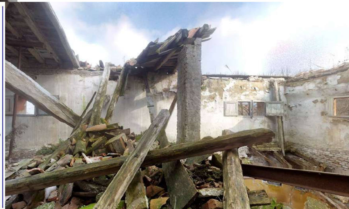
Crollo porzione di copertura.
