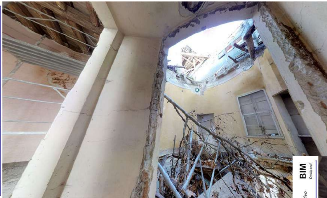
Crollo porzione di solaio di piano primo e secondo.
